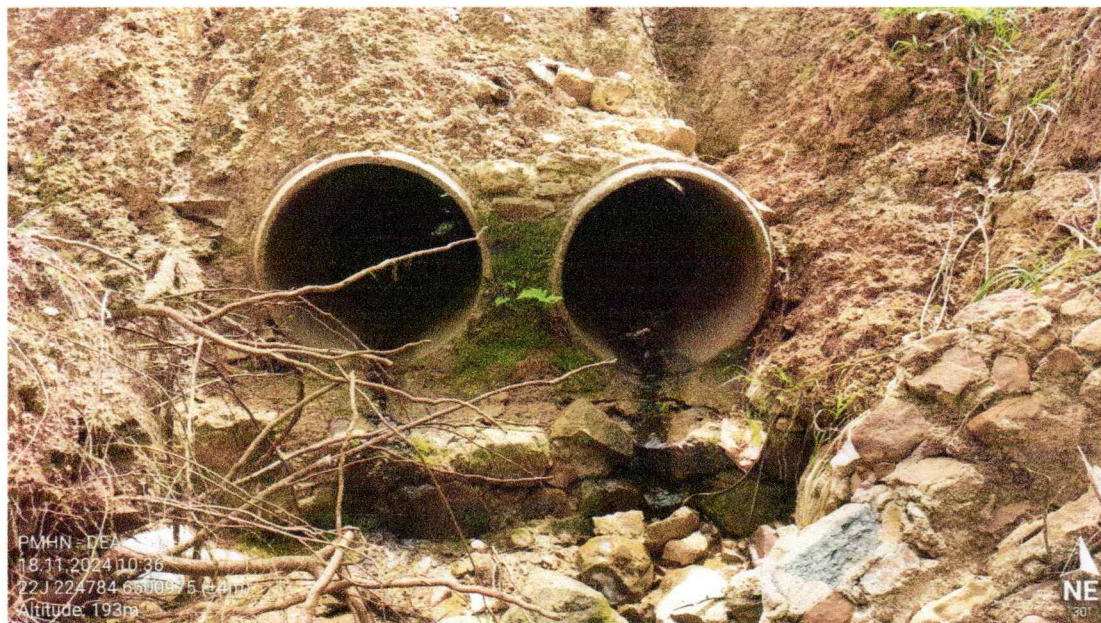
Fonte própria: sistema de drenagem existente no local
